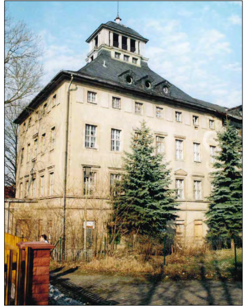
Abbildung 6: Diese Aufnahme von 1993 zeigt das 1841/42 errichtete und 1914 umgebaute Hauptgebäude in freier Ansicht. Heute ist das Bauwerk vollends von Wildwuchs umringt, von Vandalismus gezeichnet und in einem kritischen baulichen Zustand.
