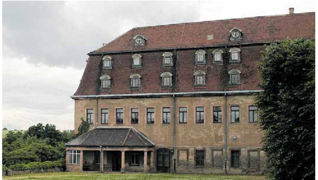
Schloss Wechselburg: Das Dach muss notgesichert werden.
