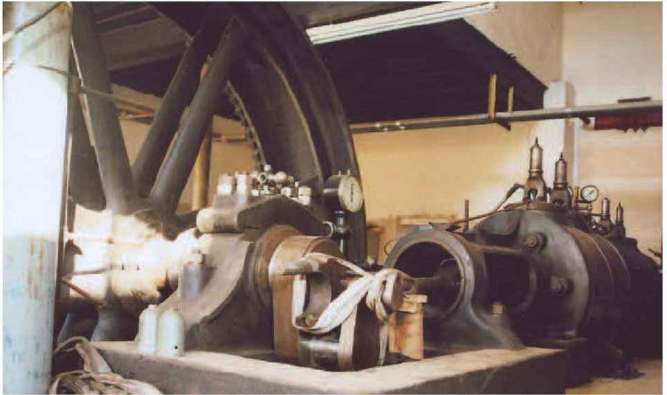
Die teildemontierte Vereinsmaschine im Zustand Anfang 2008.
