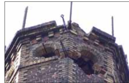
Schäden im oberen Bereich des Turm – Frühjahr 2009 - Bildquelle: Helmut Bunde
