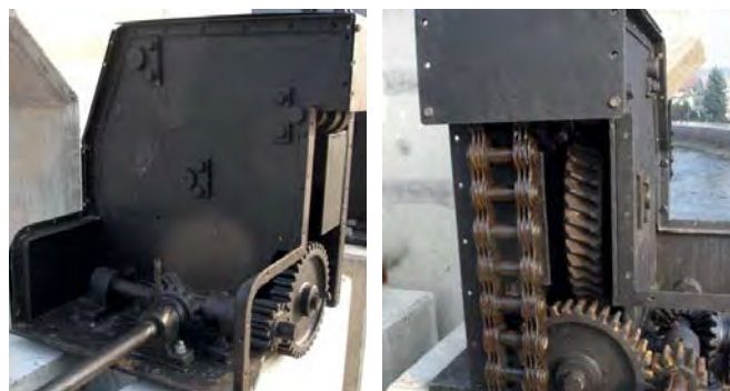
Blick in geöffnete Getriebekästen am Bediensteg der Wehranlage
