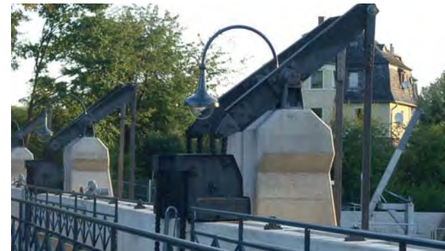
Bediensteg der Wehranlage mit auf den Pfeilerköpfen gelagerten Balancier inclusive Zugstange – im Hintergrund die ehemalige Wehrwarthe.
